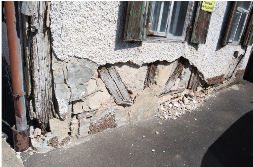
Leerstehendes baufälliges Haus im Ortskern von Uehlfeld. Foto: Marina Beck
